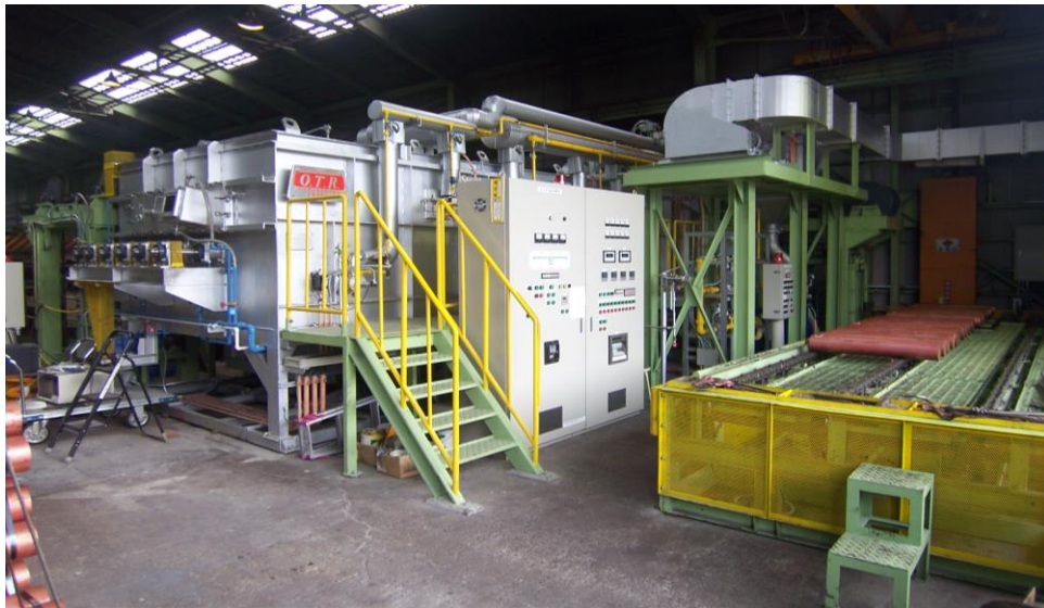
更新した熱間圧延機の加熱炉
