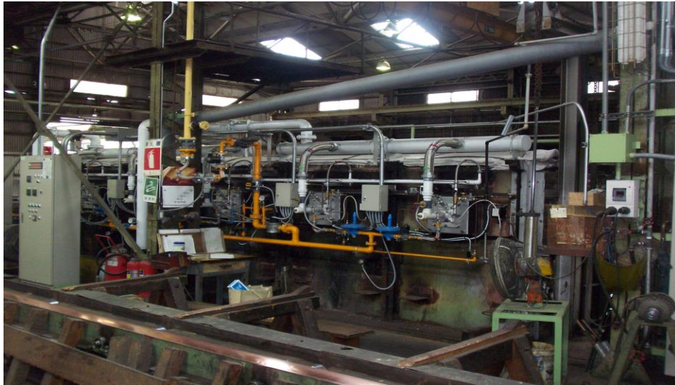
天然ガスを燃料とする改修された加熱炉
