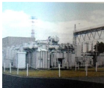
アルミタンク接続部分
